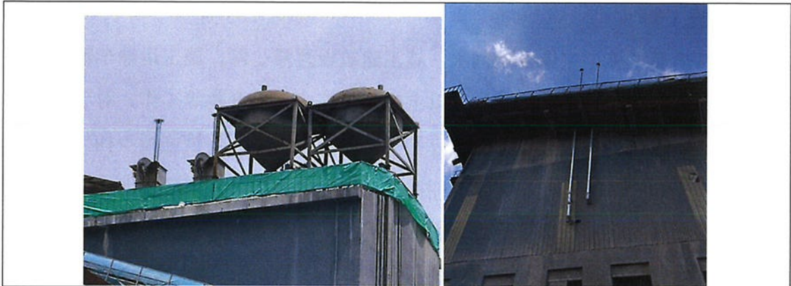
筒仓、搅拌机废气除尘设施及排气筒
