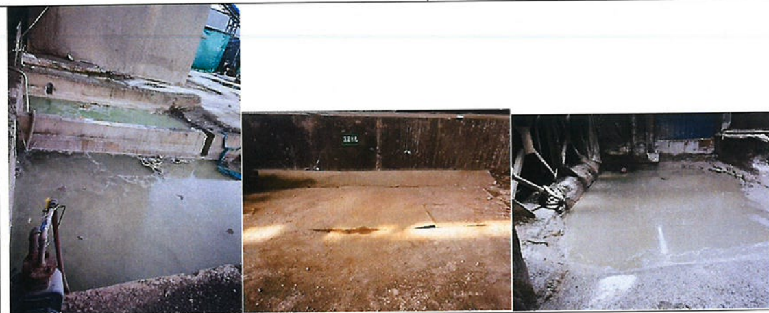
废水沉淀池（容积共 500m 3 ）
